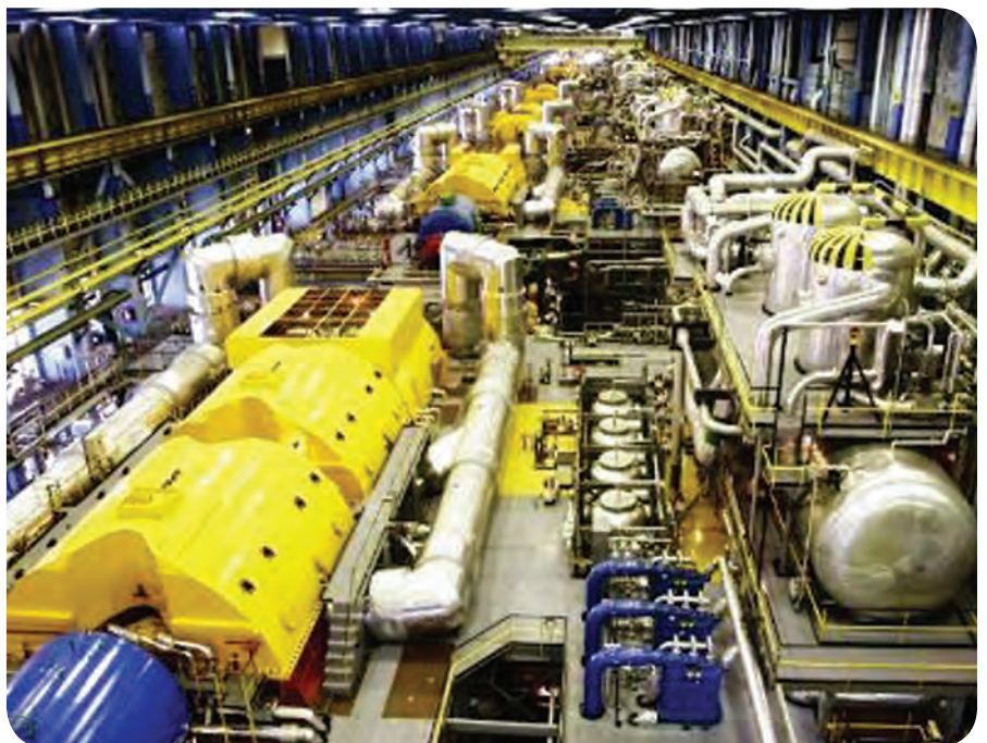
■ Hazánk legnagyobb erőművének, a paksi atomerőműnek 500 m hosszú turbinacsarnoka. A sárga fémtokok rejtik a turbinákat, hozzájuk a kék generátorok kapcsolódnak
