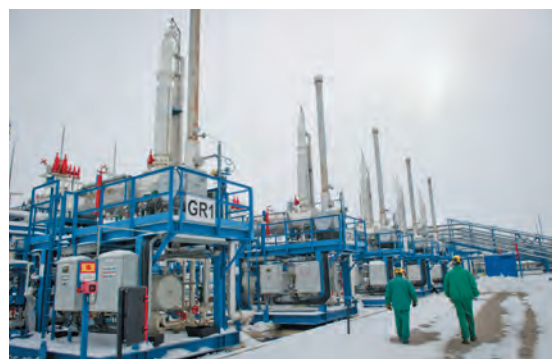
Szénhidrogén-fogadó állomás Algyő közelében
